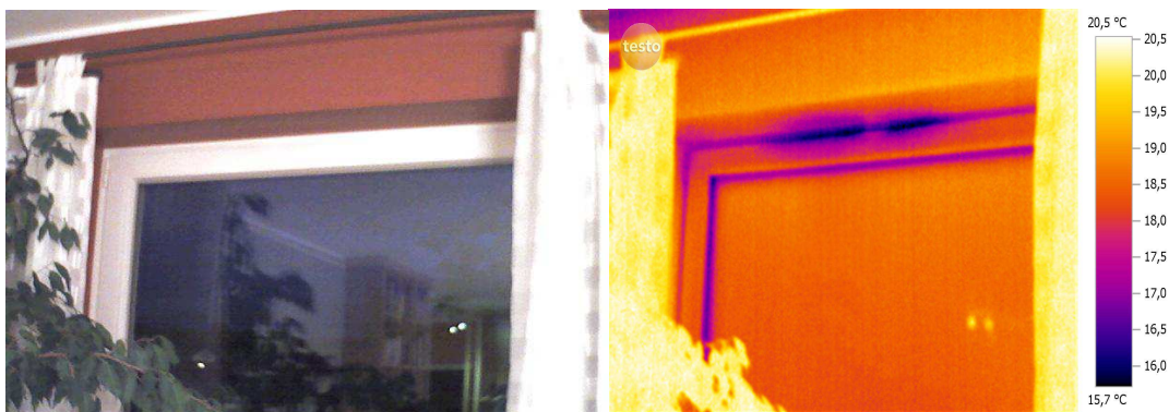
Infiltracja - wnikanie zimnego powietrza z zewnątrz
